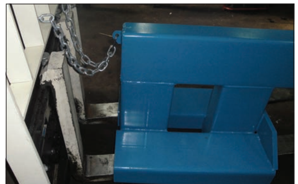
Mauvais ancrage de la potence au tablier
