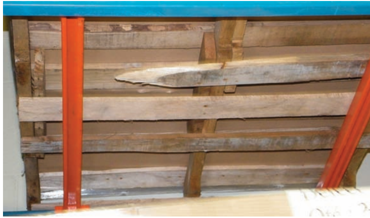
Plancher de palette endommagé
