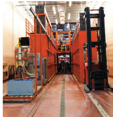
Zone de charge de batterie ventilée
