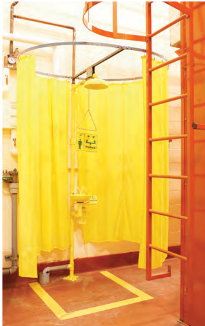
Douche de secours et douche oculaire
