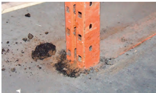
Palettier sur sol asphalté
